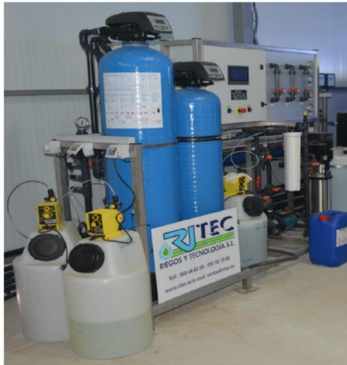
Figura 1. Equipo de osmosis inversa instalado en DRAINUSE
