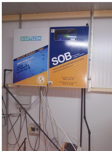
Detalle del equipo de desinfección de DRAINUSE
