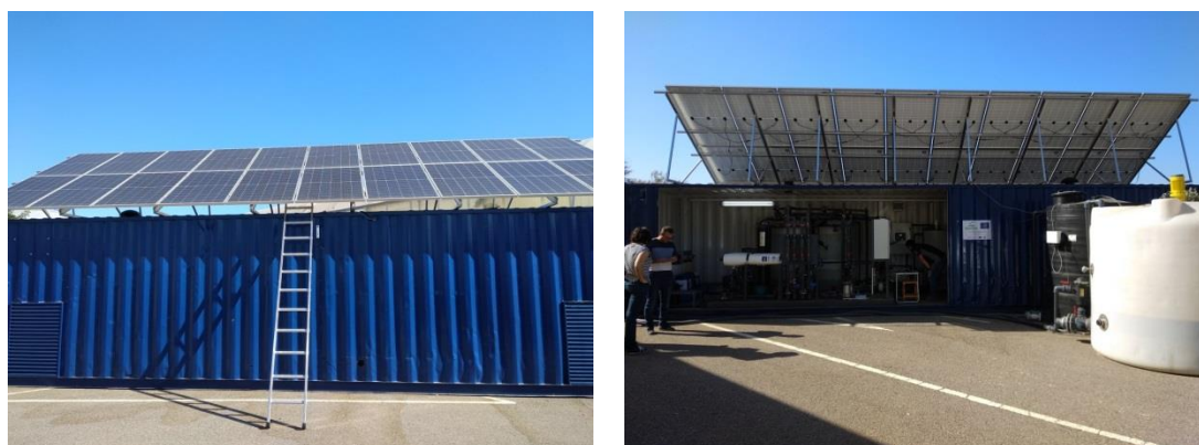
Figura 2. Planta de osmosis inversa alimentado por energía solar. Izquierda detalle de las placas solares en el tejado del contenedor. Derecha detalle del interior del módulo de osmosis inversa y depósito de lixiviado procedente del invernadero dispuesto para ser tratado.
