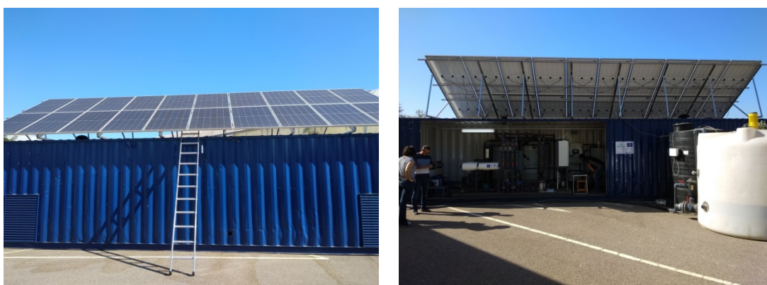
Figura 2. Módulo de osmosis inversa alimentado por energía solar. Izquierda detalle de las placas solares en el tejado del contenedor. Derecha detalle del interior del módulo de osmosis inversa y depósito de lixiviado procedente del invernadero dispuesto para ser tratado.
