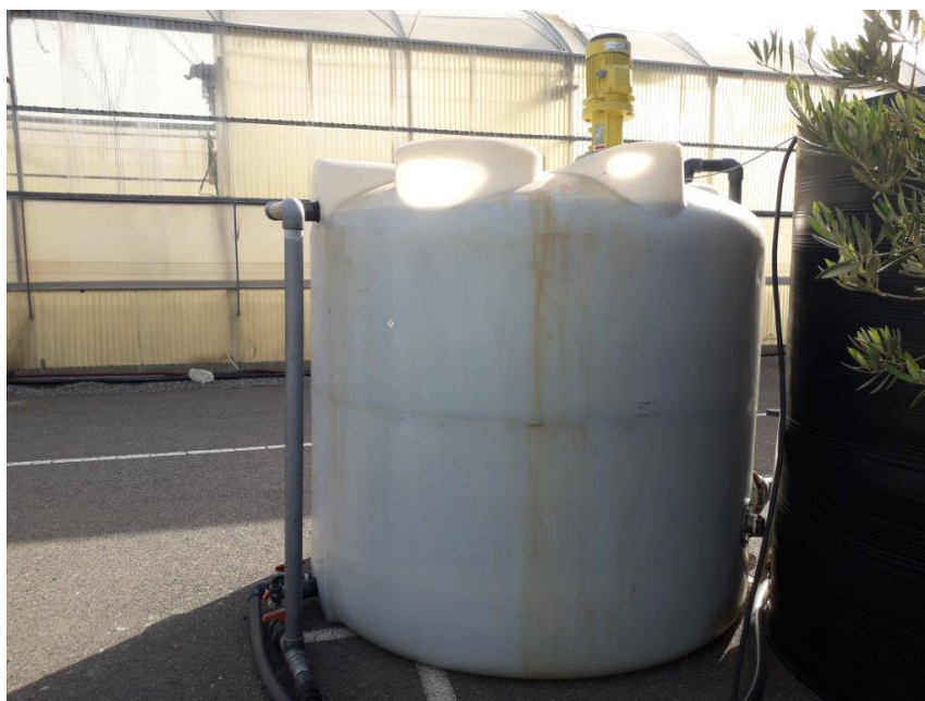
Figura 1. Tanque de almacenamiento de drenajes lleno, antes del comienzo del tratamiento.
